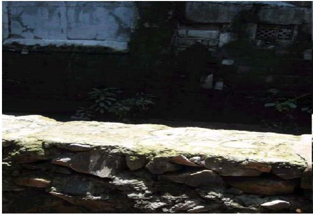
サンタリータ浸水防止用壁
