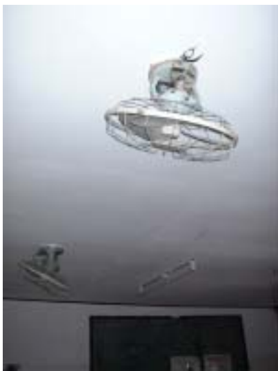
新規に設置した扇風機
